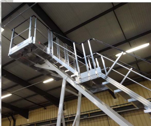
Vue sur paliers principal et intermédiaire
